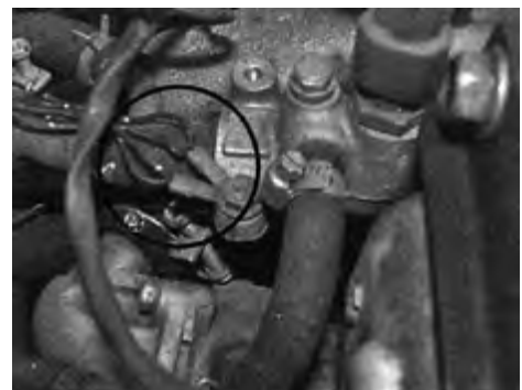
Terminal de tierra física
